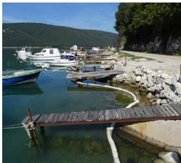
Slika 12: Obalna linija sa mnoštvom dotrajalih pontona
