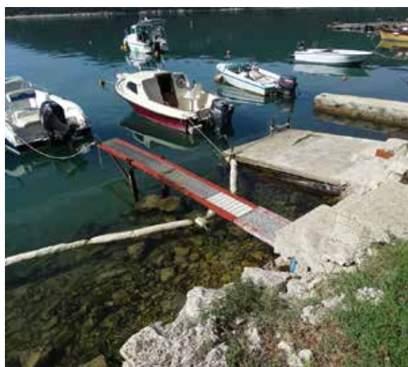
Slika 16: Obalna linija sa mnoštvom dotrajalih pontona
