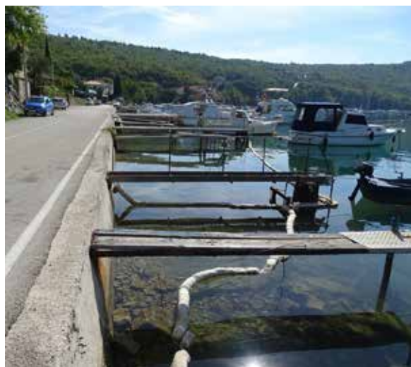
Slika 13: Obalna linija sa mnoštvom dotrajalih pontona
